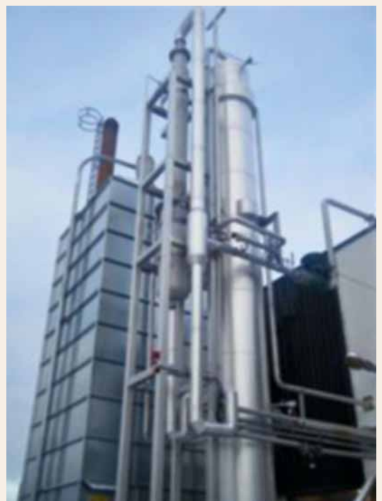
Biogassanlegget på Bekkelaget renseanlegg (foto VAV).
