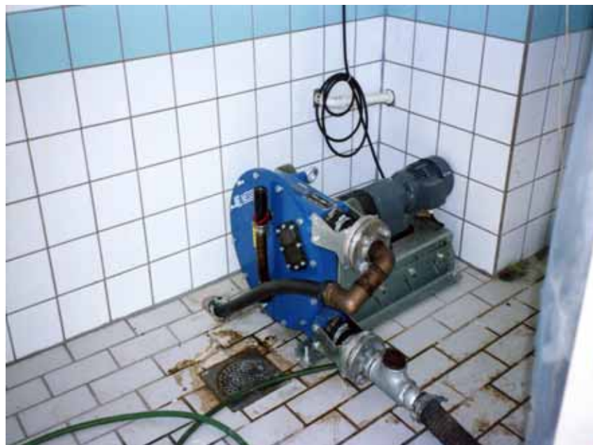
Bilde 4.5b Mottaksstasjon på Fagerstrand. Innvendig sugepumpe
