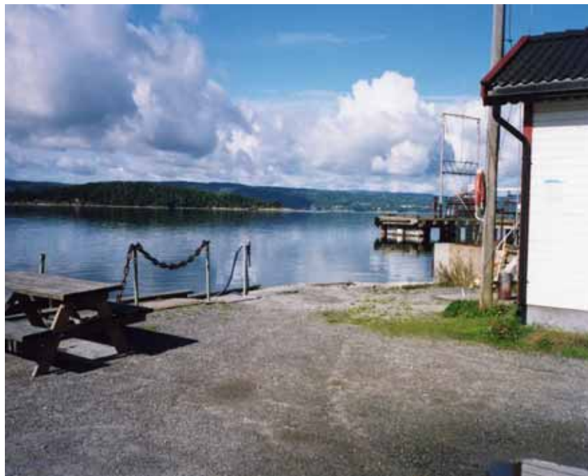
Bilde 4.5a Mottaksstasjon på Fagerstrand. Tilkopling på bryggekant
